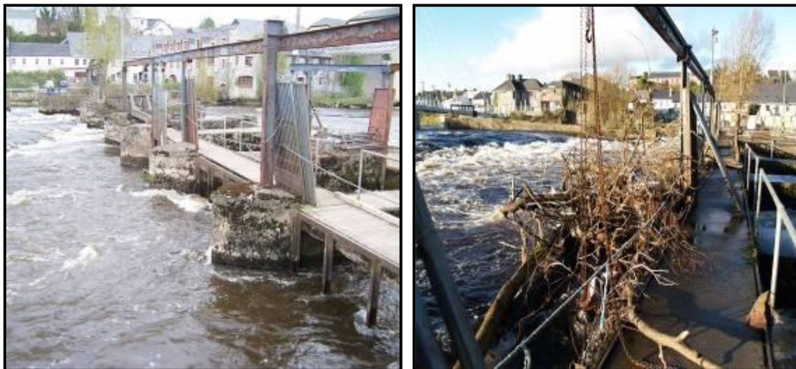
Figiúr 35. Réamhoibreacha - forstruchtúr creimthe agus neamhshábháilte le smionagar carntha sa taobh in aghaidh srutha den chora
